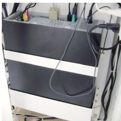
▲省スペースのため縦に設置されているPR-80
